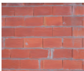
Mauvaise pose réduisant la qualité du matériau utilisé
